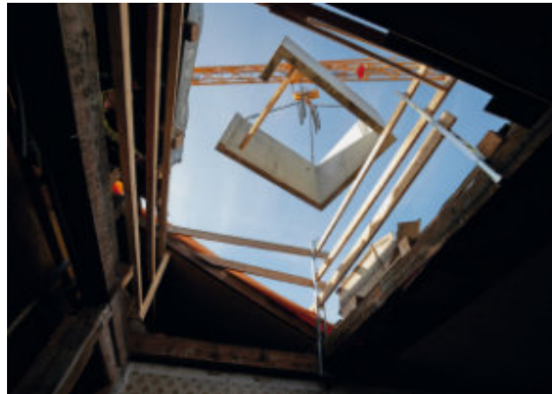
Die Sanierung griff Tief ins Gebäude ein, dank offenem Dach liessen sich ganze Bauteile einfliegen.
